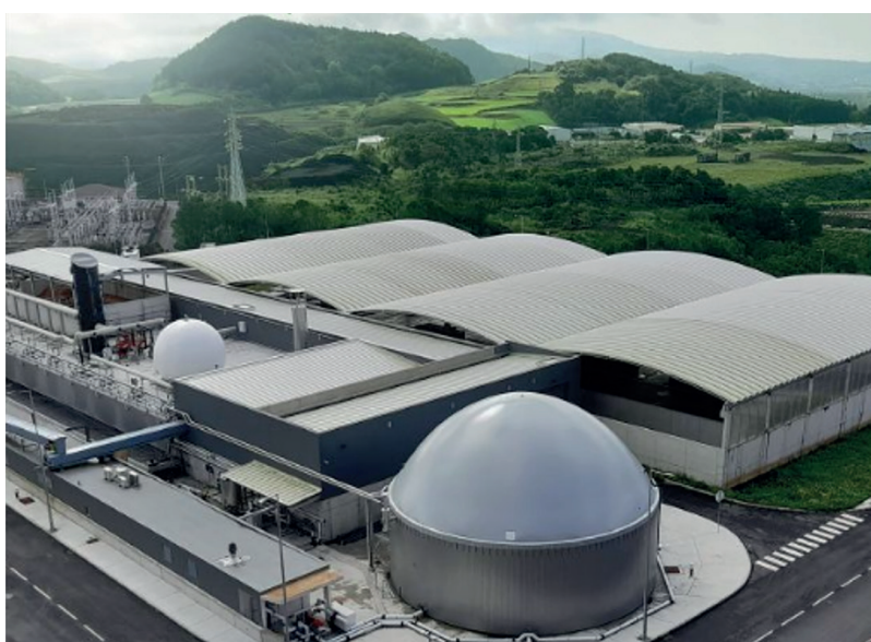
Centro de tratamento biológico (CTB)
